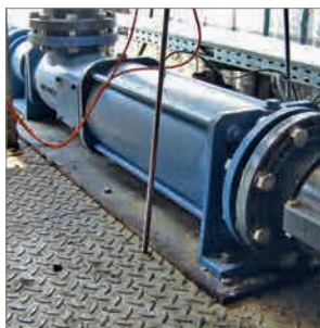
Přečerpávání substrátu mezi fermentory
