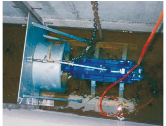
Ponorné míchadlo v kruhovém kanálovém systému
