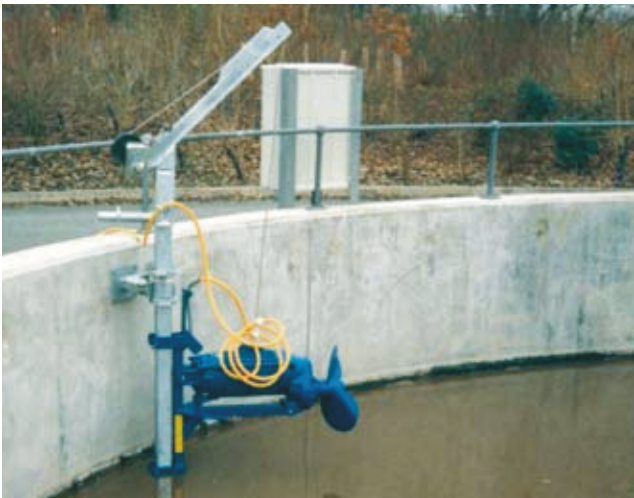
Ponorné míchadlo GTWSI 1040 v otevřené jímně na čistárně odpadních vod
